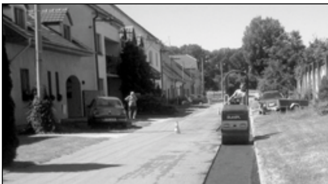
Poničená vozovka se opravovala také na dolním konci
